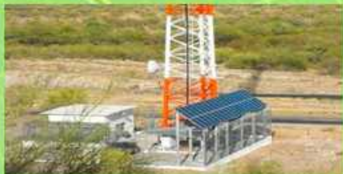
Sistemas solares para telecomunicaciones.
