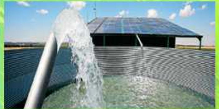
Sistemas de bombeo solar para reservorios u acueductos comunitarios.
