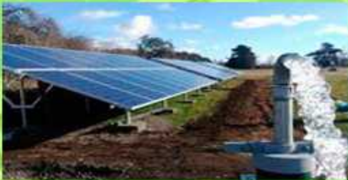
Sistemas de bombeo solar para riego agrícola.
