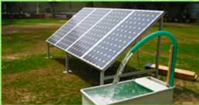
Sistemas de bombeo solar de uso residencial.
